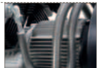
Aluminium- Rippenrohr- Nachkühlerleitung im Kühlluftstrom
